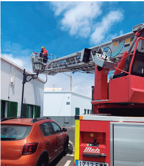
CABLE CAÍDO - SAN BARTOLOME
