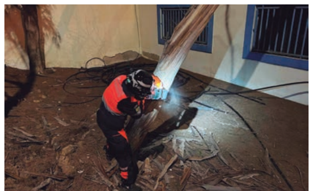
Asistencia árbol con peligro de caer. Carretera Las Caletas, Arrecife.
