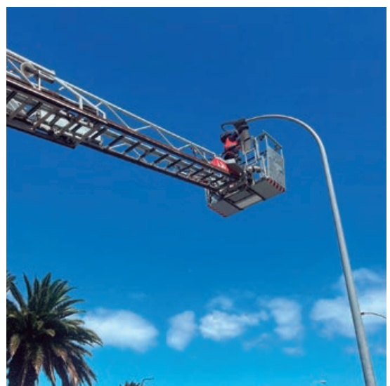
Asistencia farola con peligro de caer. Calle Juan Negrín, Arrecife.
