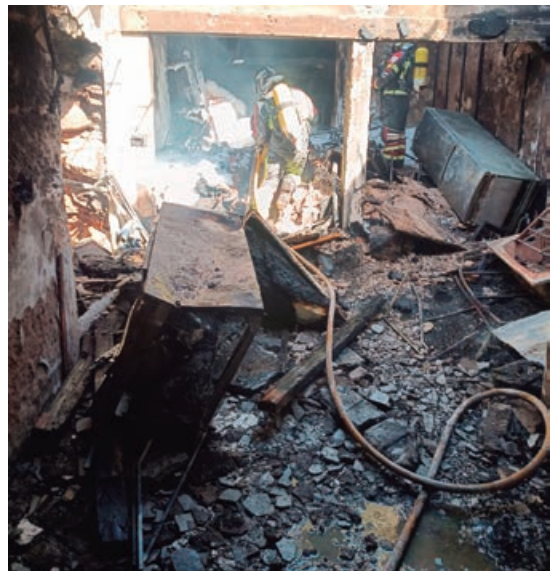
Incendio casa abandonada. Calle Fajardo. Arrecife.
