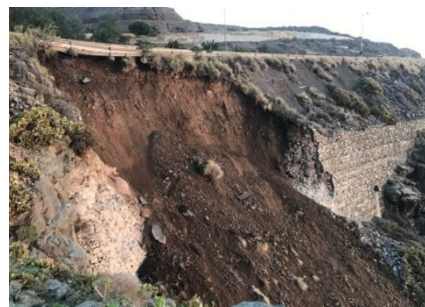
Ilustración 9. Derrumbe carretera GC-1. Isla de Gran Canaria
