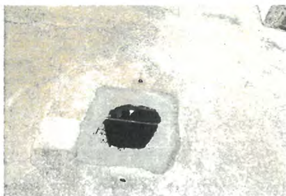
FOTONº3 VISTA DEL BRÓCAL DERRUIDO
