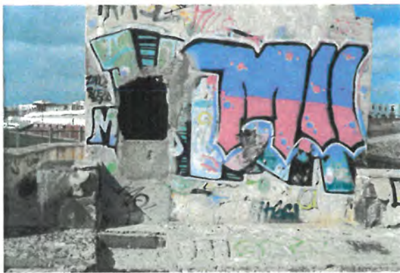
FOTONº2 VISTA DE LA PARED DERRUIDA
