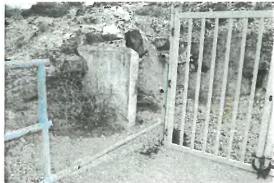
FOTO Nº3 VALLA DE LA PASARELA
