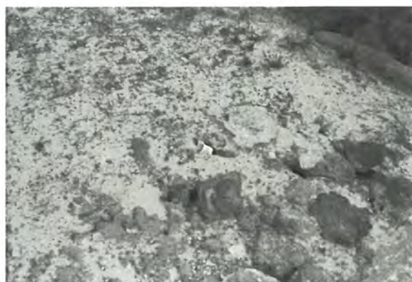
FOTO N°3 VISTA DEL TECHO EROSIONADO
